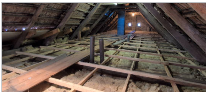
PŮDA PŘED ZATEPLENÍM
